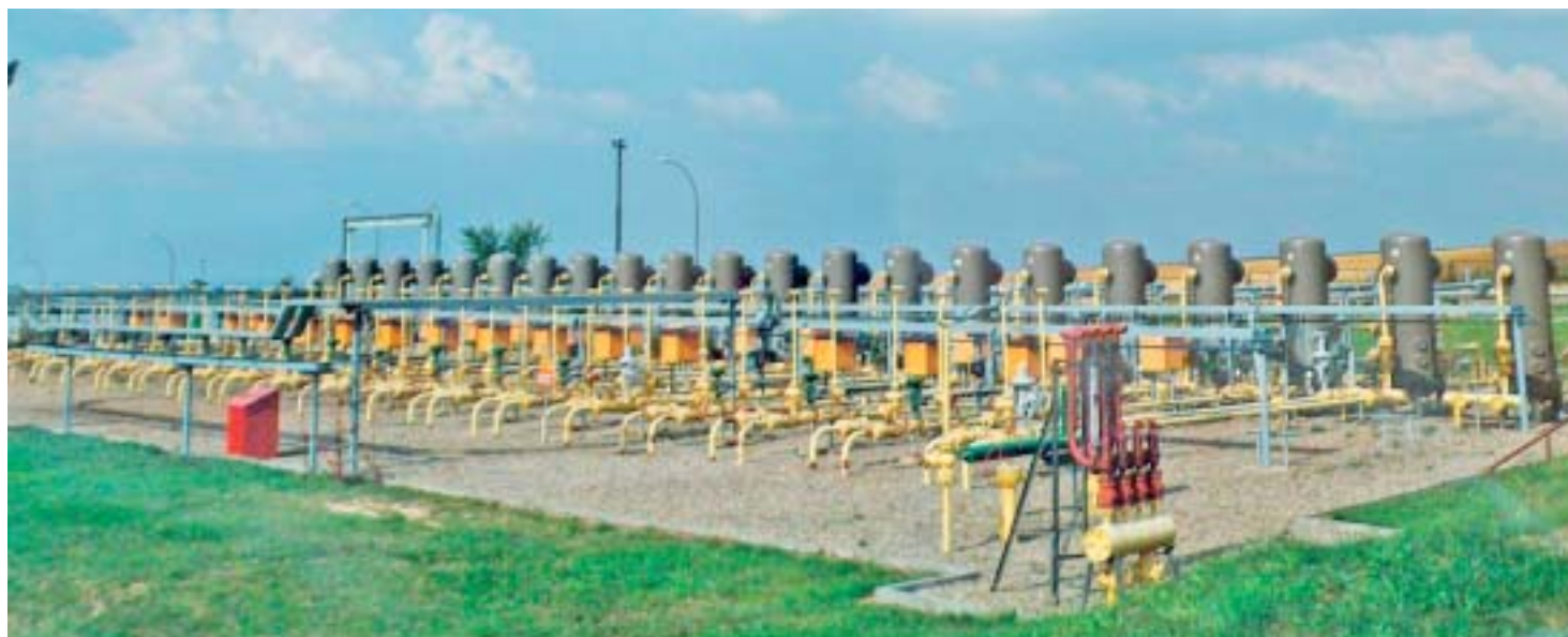
Instalacja wstępnego oddzielania wody złożowej.
