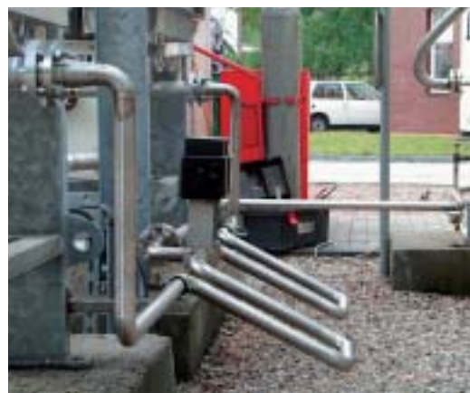
Fragment instalacji LNG
