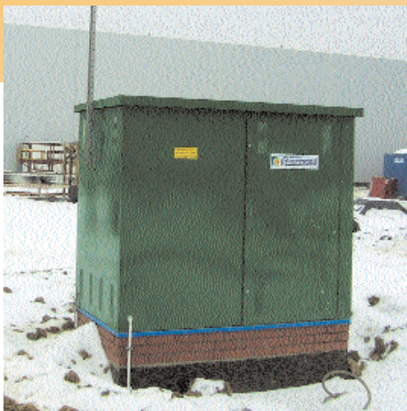
Stacja redukcyjna na terenie rozbudowywanej fabryki autobusów Solaris Bus&Coach w Bolechowie
