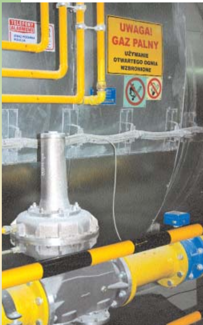
Fragment instalacji gazu ziemnego w zakładach gipsowych „Dolina Nidy”
