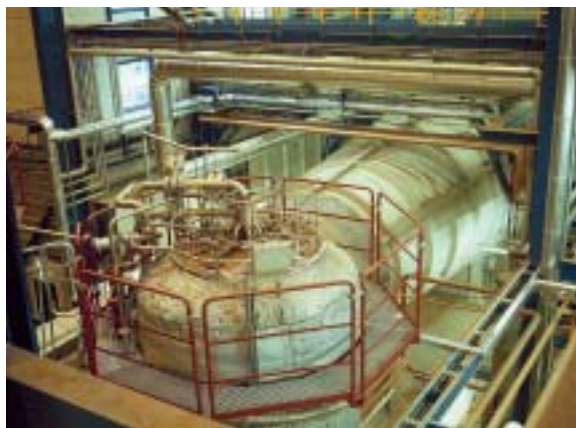
Pracujący w skojarzeniu blok parowo-gazowy w EC Lublin-Wrotków. Fot. EC Lublin-Wrotków
