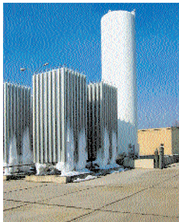
Instalacja regazyfikacji LNG
