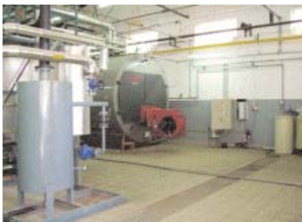
Widok nowej kotłowni gazowej
