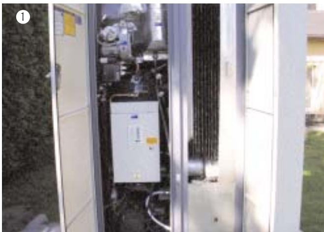
Wnętrze urządzenia BCT 23.
