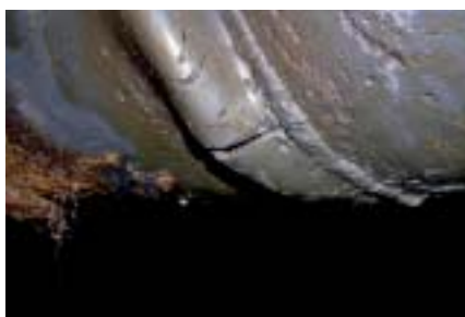
Fala i pęknięcie ścianki rury. Średnica gazociągu 500 mm, grubość 10 mm.
