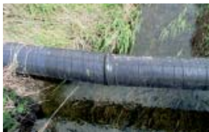
Fala na gazociągu o średnicy 200 mm, powstała wskutek przejścia frontu górniczego w odległości 300 metrów od miejsca pokazanego na zdjęciu.
