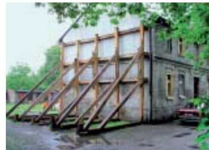
Budynek usytuowany nad polem eksploatacyjnym kopalni węgla, do natychmiastowej rozbiórki.
