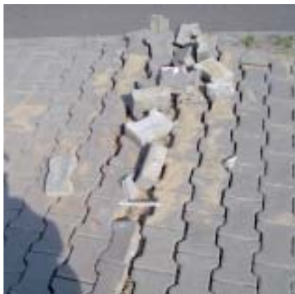
Efekt osiadania terenu jest w tym wypadku „nadmiar” chodnika.
