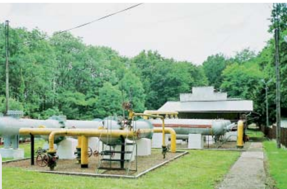
Elementy instalacji osuszania gazu w PMG Strachocina
