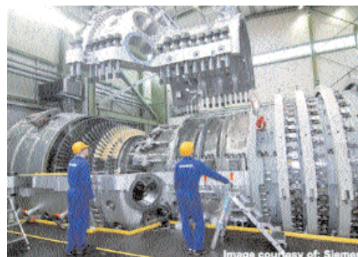
Turbina gazowa typu SGT5-8000H. Moc turbiny: 340 MW el , temperatura pracy TIT do 1500°C, sprawność: ponad 38%. Waga turbiny: 440 ton. Nad turbiną na suwnicy widoczna część „gorąca” z gniazdami do zainstalowania palników gazowych.
