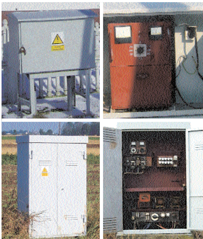
Rys. 1. Przetwarzane urządzenia polaryzujące stosowane w stacjach ochrony katodowej gazociągów w latach osiemdziesiątych i dziewięćdziesiątych, typu SOK IV (u góry) i CVA 60/20 (na dole)
