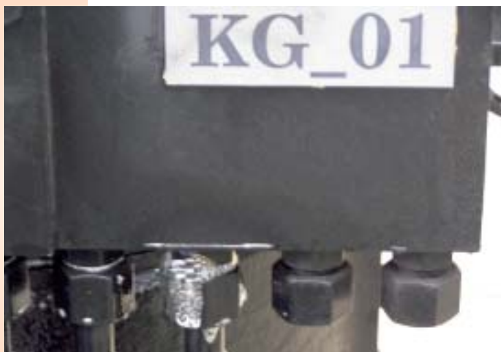
Rys. 1. Zidentyfikowany przez system ALMA wyciek gazu na zespole zaporowo-upustowym.
