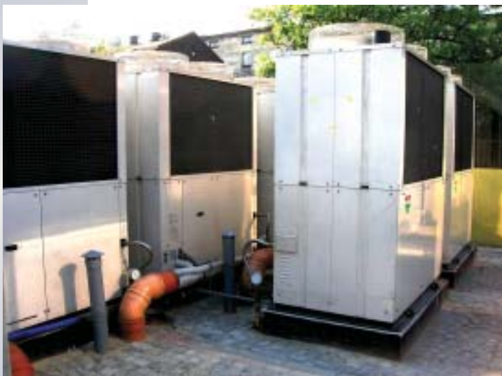
Układ gazowych pomp ciepła.
