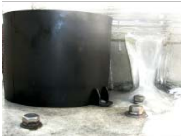
Oblodzenie przy obudowie wentylatorów.
