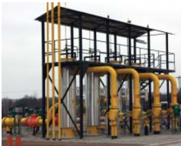
Układ filtracyjny węzła Lubienia.
