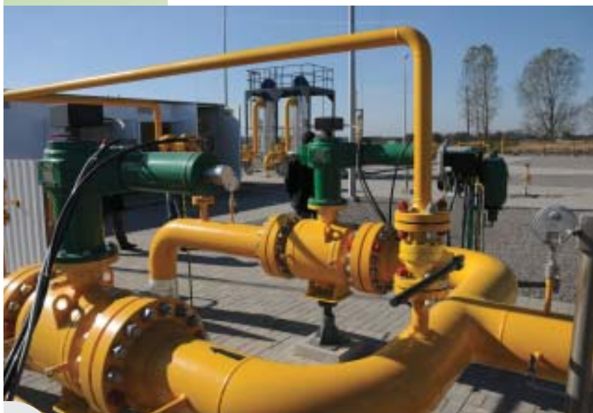
Stacja redukcyjno-pomiarowa I stopnia w Czółkach, ciśnienie 5 MPa, przepustowość Q=30\ 000\ \text{nm}^3 . Stacja może mierzyć strumień gazu z dwóch kierunków – z gazociągu ukraińskiego z kierunku Hrubieszowa i gazociągu od strony polskiej DN 200/250 Lubaczów Krasnystaw.
