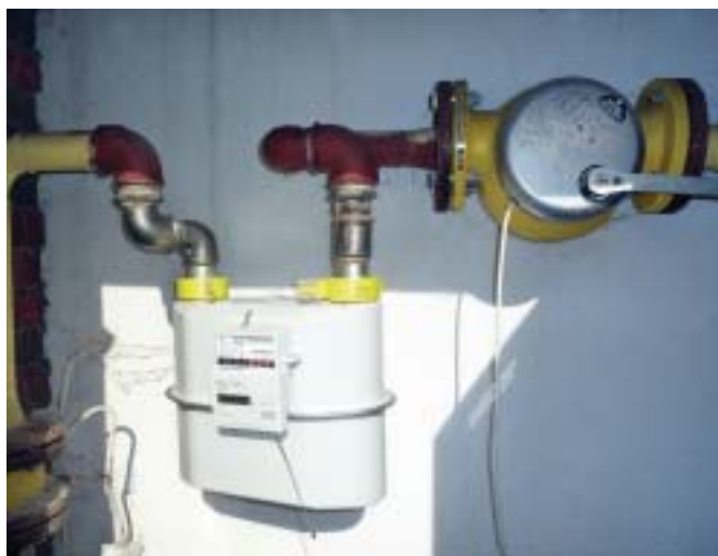
Układ automatycznej optymalizacji ciśnienia w sieci firmy Fiorentini.
