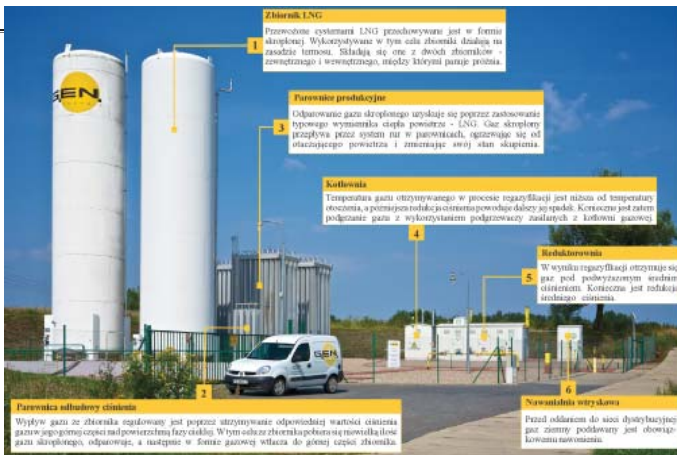
Należąca do G.EN. GAZ ENERGIA S.A. stacja regazyfikacji LNG w miejscowości Miastko i zasada jej działania.
