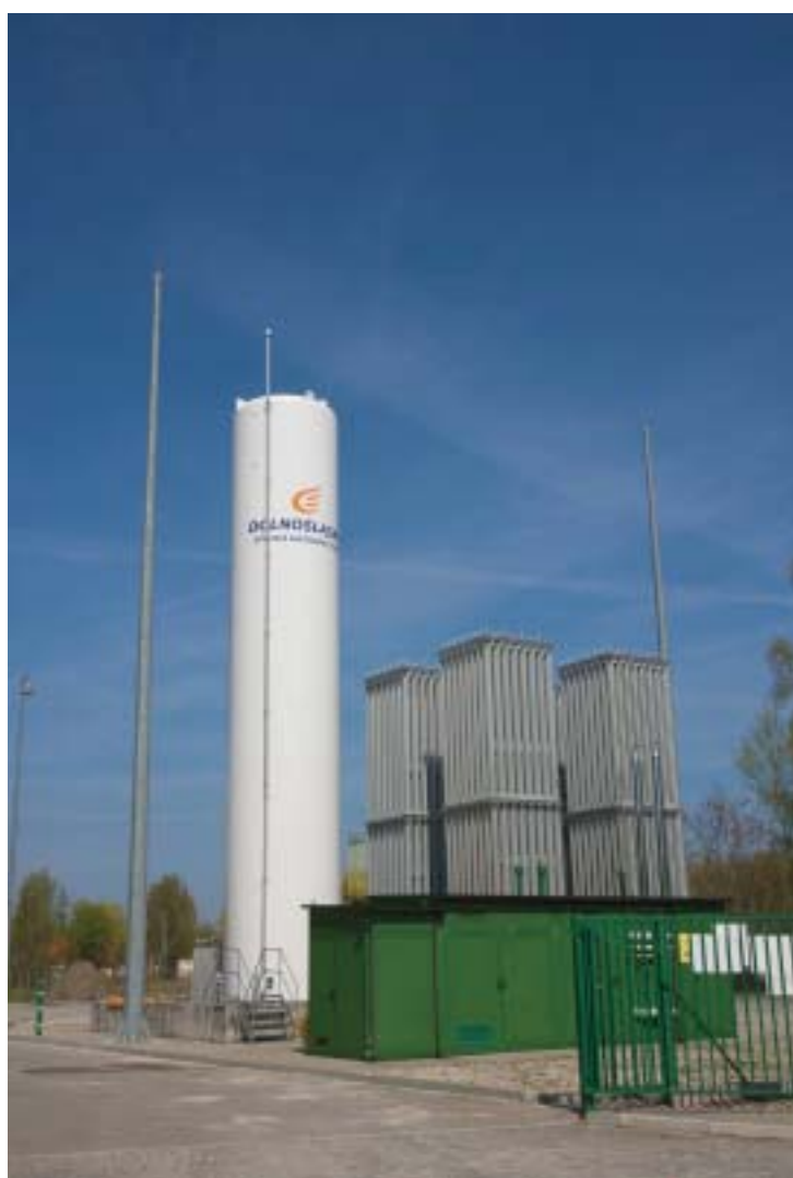
Stacja regazyfikacji LNG w Świętoszowie.
