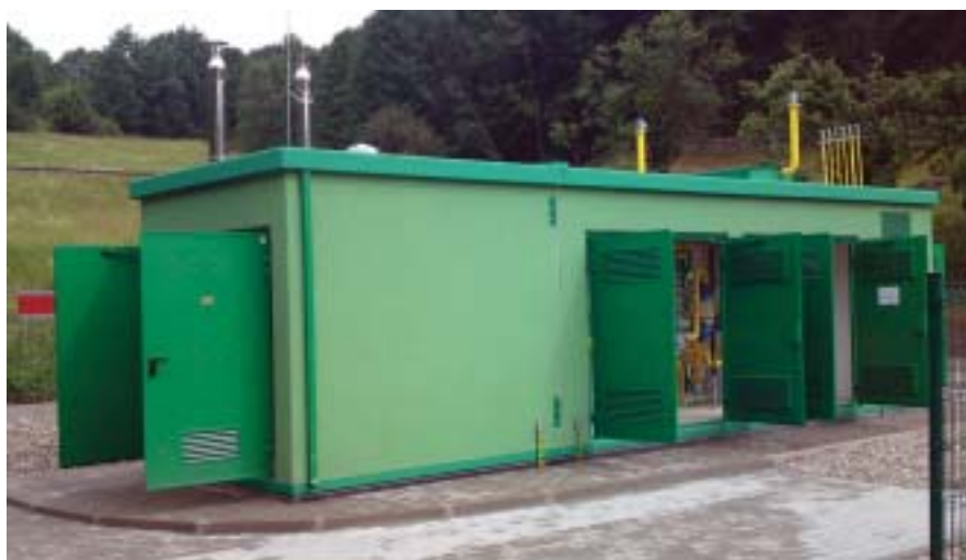
Stacja gazowa cGAS controls.
