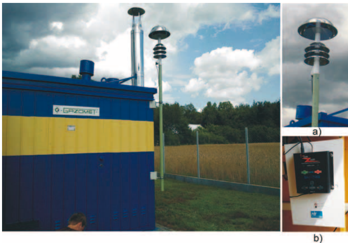
Instalacja systemu ostrzegania przed burzami Thor Guard na stacji gazowej: a) czujnik pola elektrostatycznego; b) jednostka procesorowa.
