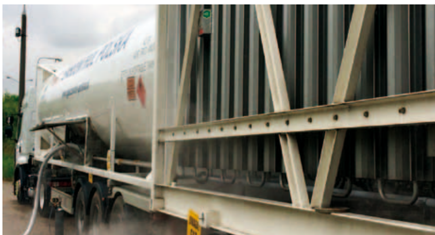
Fot. 1. Mobilny zestaw do regazyfikacji gazu skroplonego LNG w czasie pracy.
