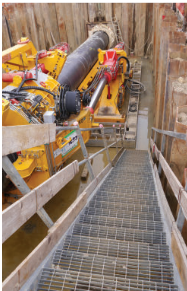
Jednoetapowa instalacja gazociągu w technologii Direct Pipe, wciskany Pipe thrasterem gazociąg wyposażony jest na czole kolumny rur w głowicę urabiającą (jak na zdjęciu obok).
