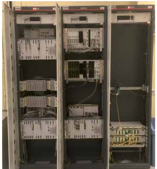
Węzeł łączności SDH w tłoczni gazu. Fot. archiwum EuRoPol GAZ s.a.
