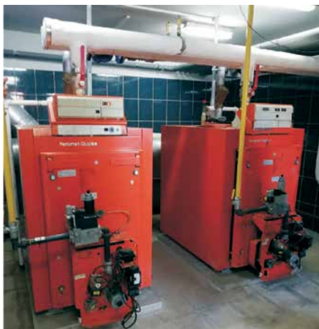
Aktualny stan techniczny kotłowni gazowej w hotelu GEOVITA w Złockiem.
