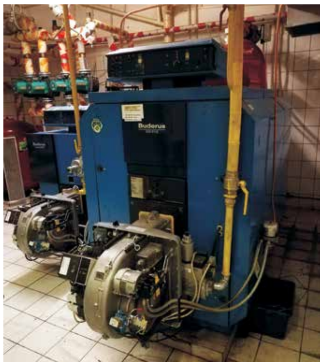
Kotłownia dwupaliwowa Perła Bieszczadów.
