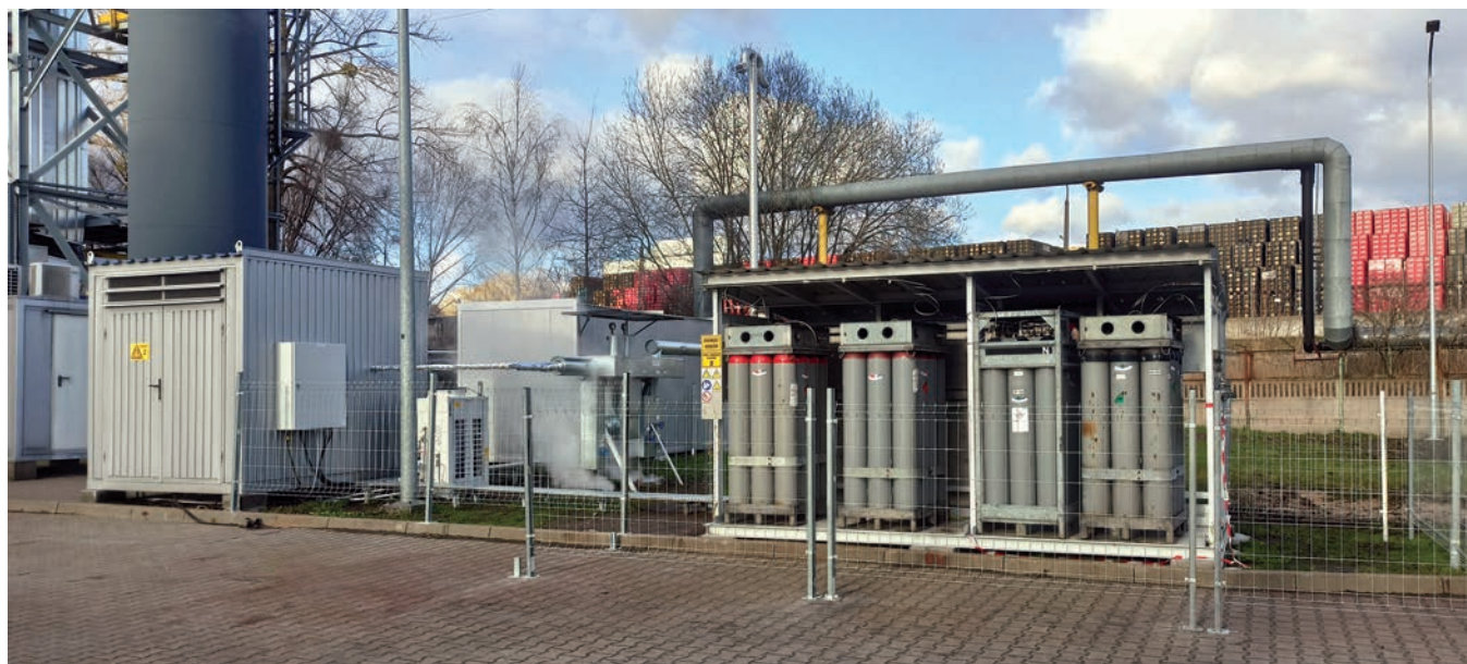
Rysunek 2. Zdjęcie instalacji rSOC w trakcie realizacji prac badawczych
