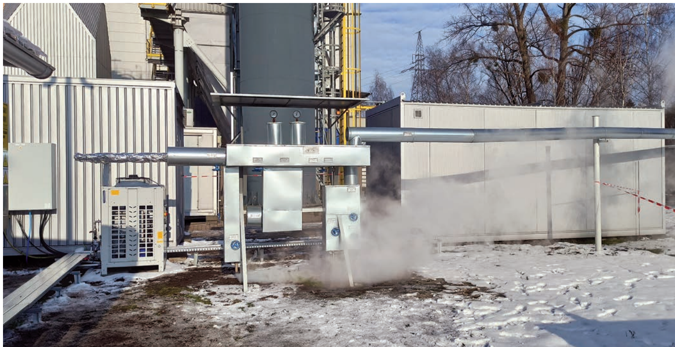
Rysunek 4. Stacja rozprężania pary w trakcie pracy. Doprowadzenie pary technologicznej z bloku biomasowego do instalacji rSOC
