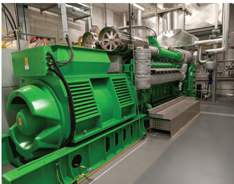
Silnik gazowy firmy Jenbacher zainstalowany w Przemysłu.
