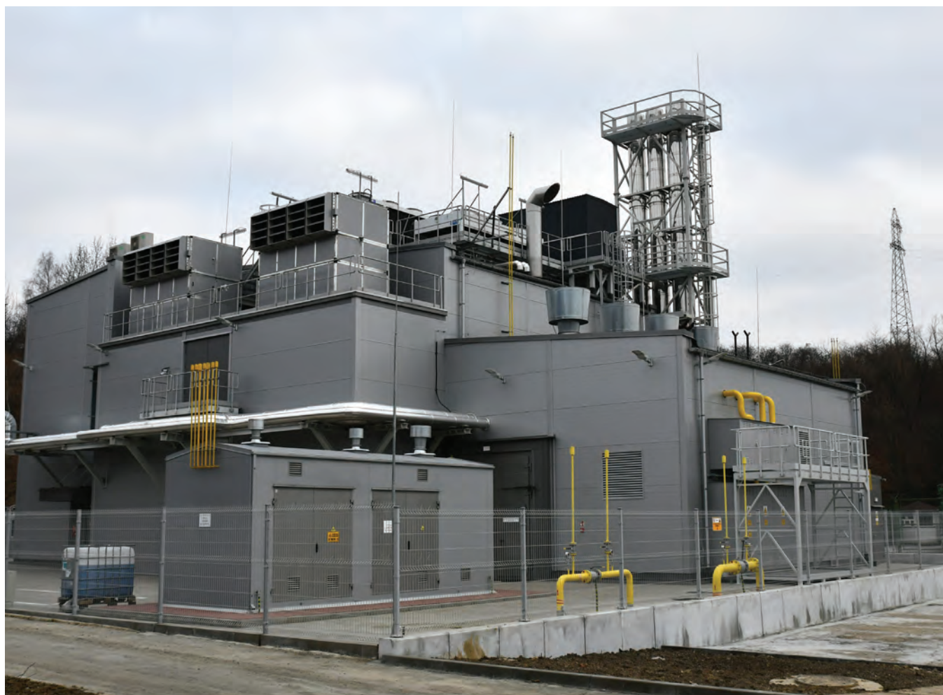
Elektrociepłownia w Przemyślu.
