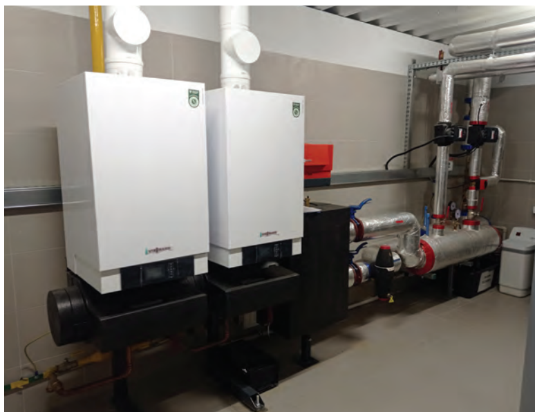
Kotłownia gazowa Osiedla MDR w Toruniu.
