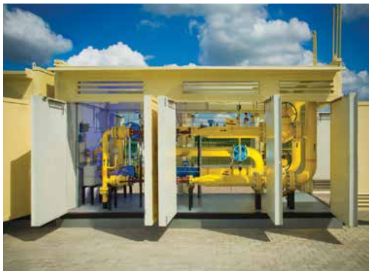
Stacja gazowa – układ pomiarowy.
