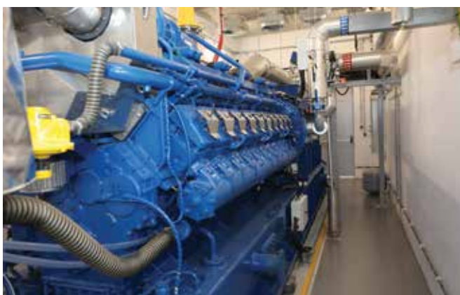
Nowy agregat prądowłóczy w Zakładzie Jastrzębie-Zdrój.
