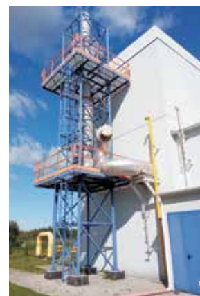
Fot. 3. Komin wylotowy spalin silnika gazowego.
