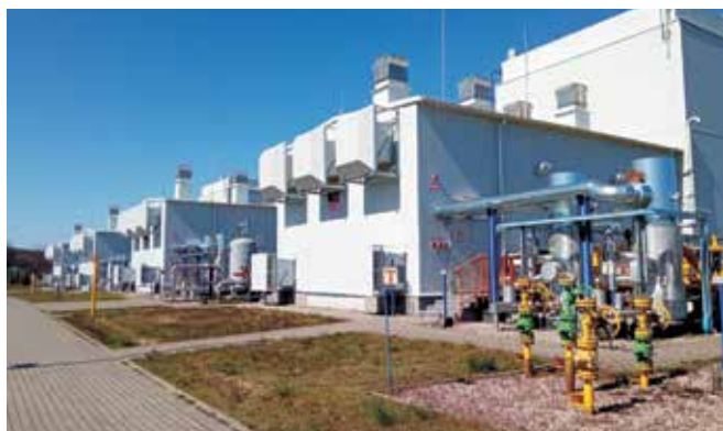
Fot. 1. Agregaty sprężające, widok ogólny po zakończonym I etapie modernizacji mającej na celu ograniczenie hałasu emitowanego do środowiska.
