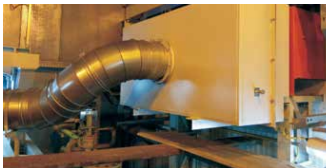
Fot. 2. Tłumik na czerpni powietrza dolotowego.
