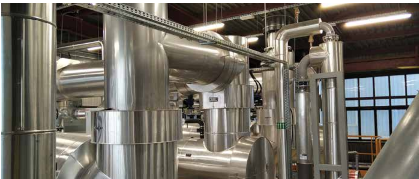
Wyrowadzenie spalin – odzysk ciepła.
