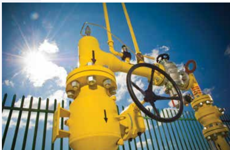
Stacja gazowa – ciąg obejściowy.
