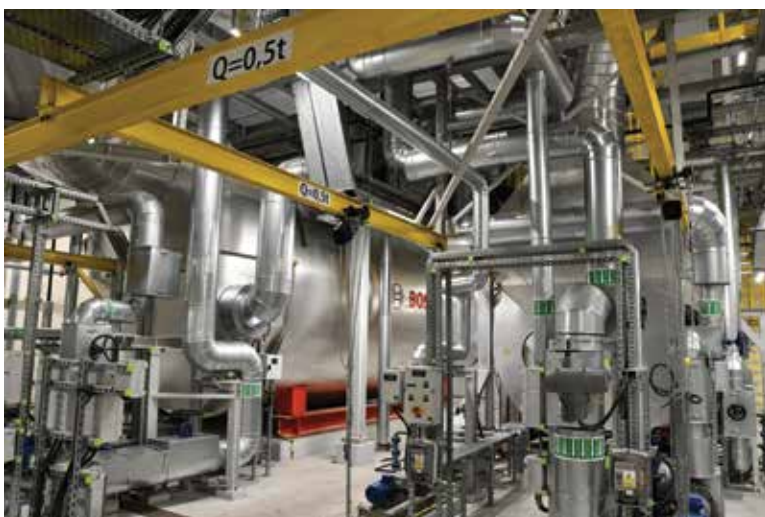
Kotłownia olejowo-gazowa w Ec Pruszków.
