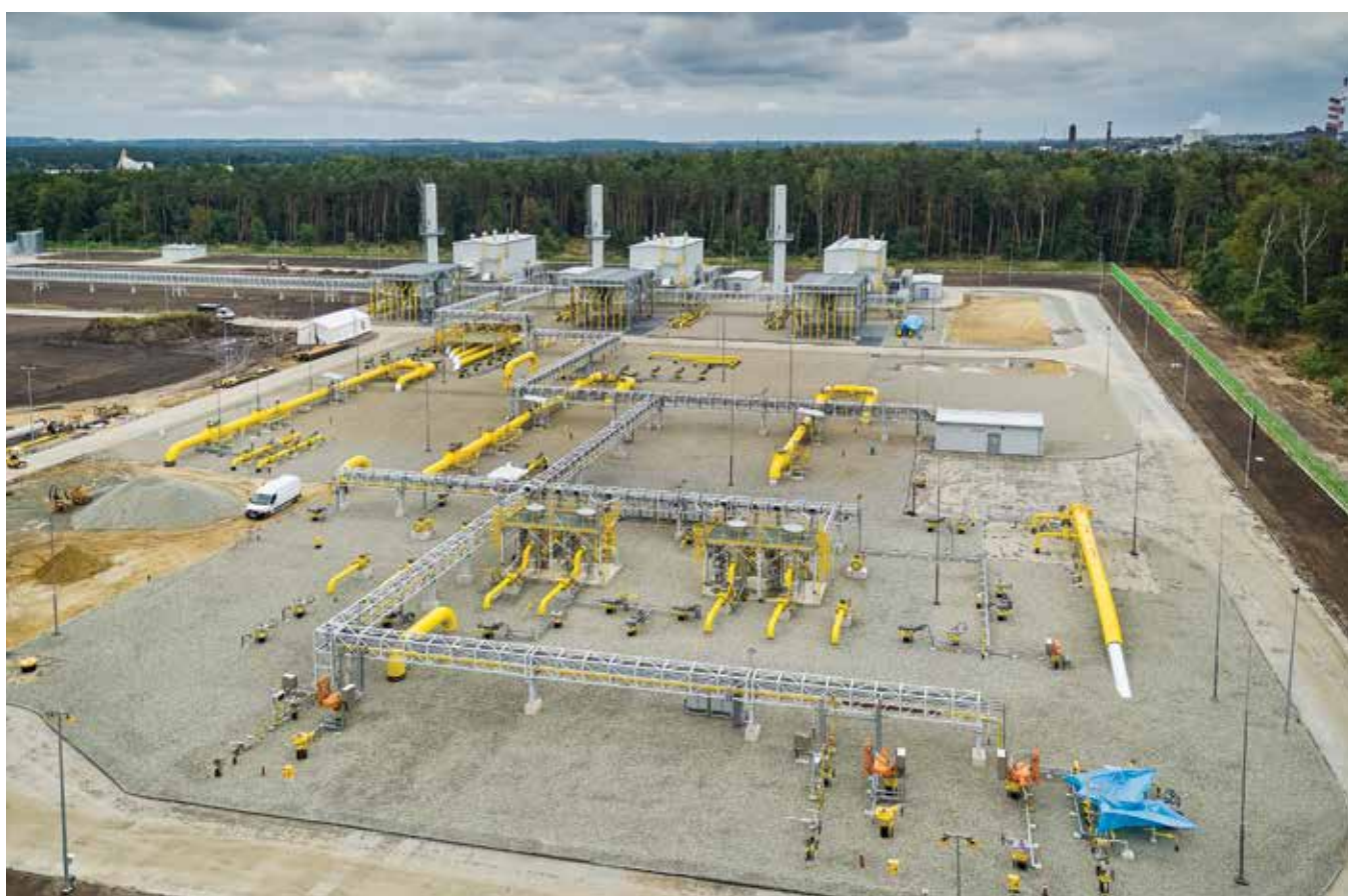
Zdjęcia pochodzą z etapu budowy tłoczni. Obecnie obiekt pracuje już pełną mocą.
