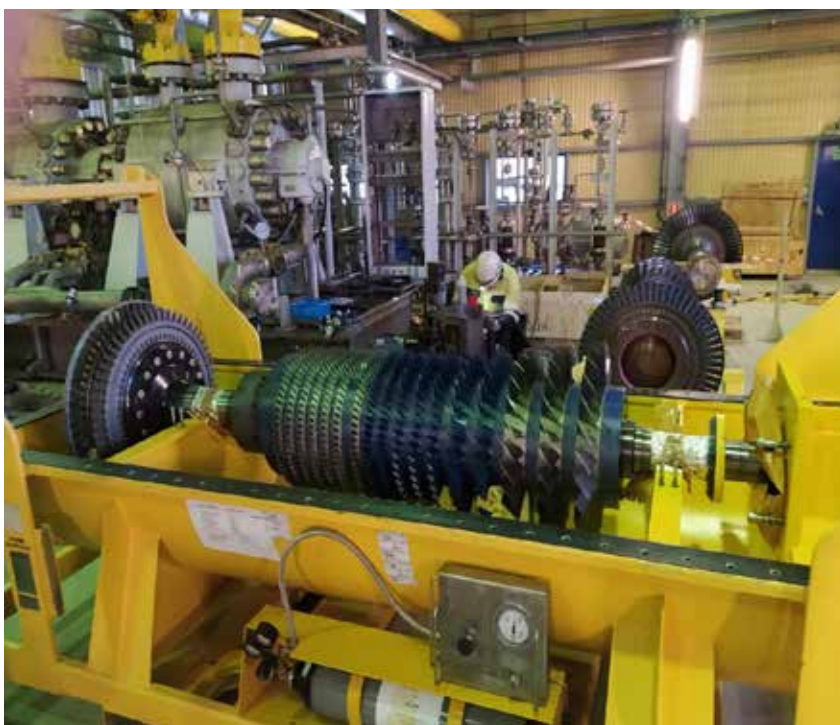
Nowy wał wysokiego ciśnienia HP, przygotowany do montażu w trakcie remontu głównego turbiny. Waga 2050 kg.
