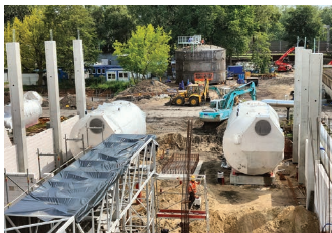
Widok instalacji KG-2.
