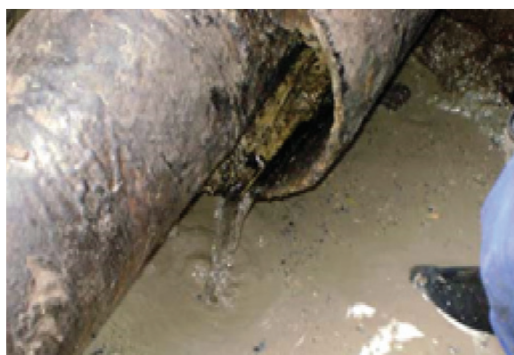
Zwarcie galwaniczne, metaliczne rury ochronnej z gazociągiem spowodowane brakiem zachowania współosiowości układu rurowego.
