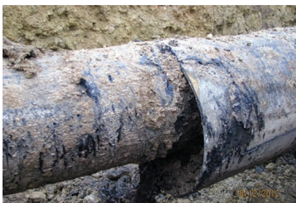
Zwarcie elektrolityczne rury ochronnej z gazociągiem spowodowane rozszczelnieniem układu rurowego.
