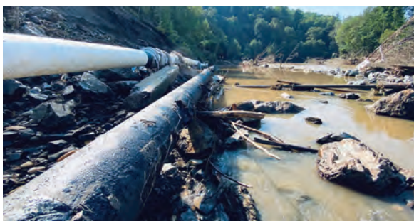
Awaria gazociągu DN 300 relacji Ołtaszyn–Kudowa.
