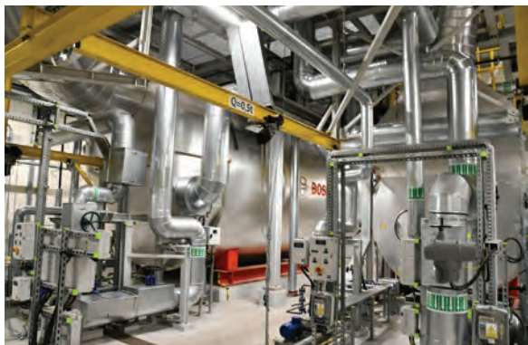
Pruszków – kotłownia gazowo-olejowa już pracuje.
