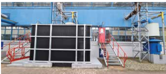
Rysunek 2. Pilotażowa instalacja bariery akustycznej dla wytypowanej tłoczni gazu.
